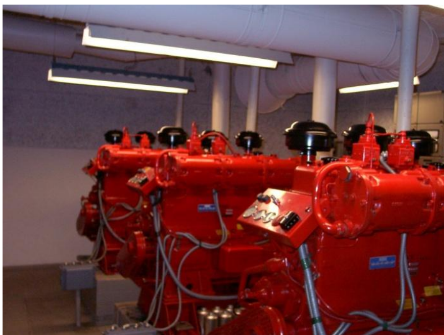
Nødgeneratorer. Foto Mark Ulf Andersen 2007
