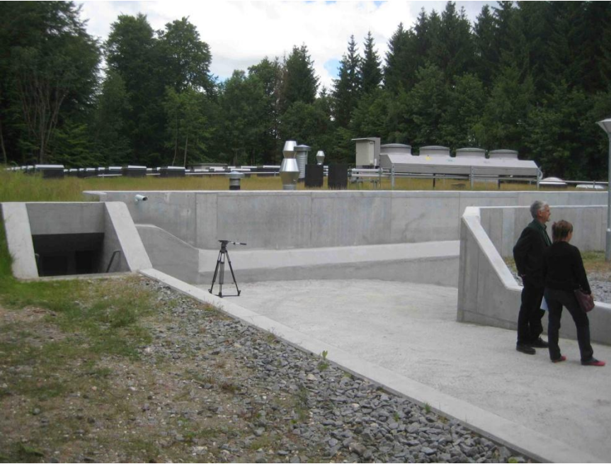
Her ses bunkeren efter ombygningen. Oven på bygningen ses toppen af apparaturet der holder en konstant luftfugtighed på 30 procent og en temperatur på minus fem grader. De sorte "kasser" er eksplosionsåbninger der skal tage trykket og sørge for, at en brand i nitratfilmene ikke breder sig yderligere. Foto: Nationalmuseet.
