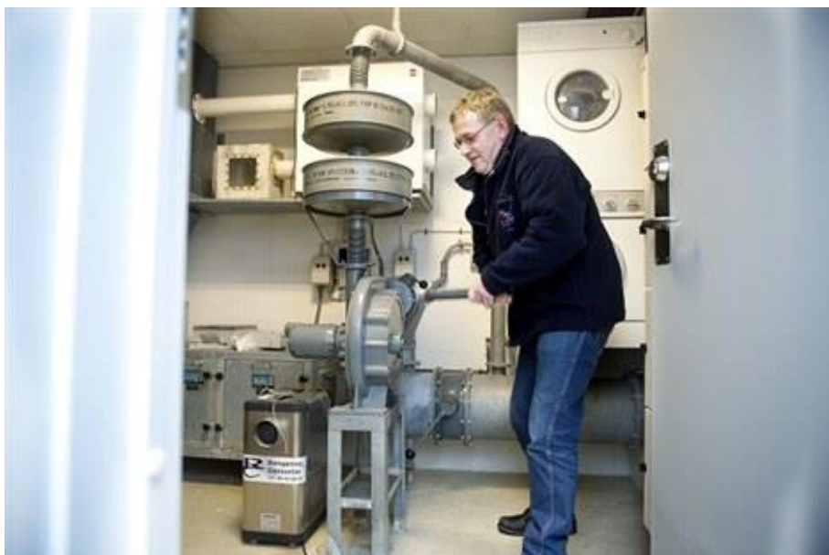
Luftrensesystem som kan betjenes manuelt i tilfælde af strømudfald af både by-strøm og fra nødgeneratoren. På billedet er det Hjørrings beredskabsinspektør Jesper Ludvigsen. Foto: Bente Poder, Nordjyske 2010.
