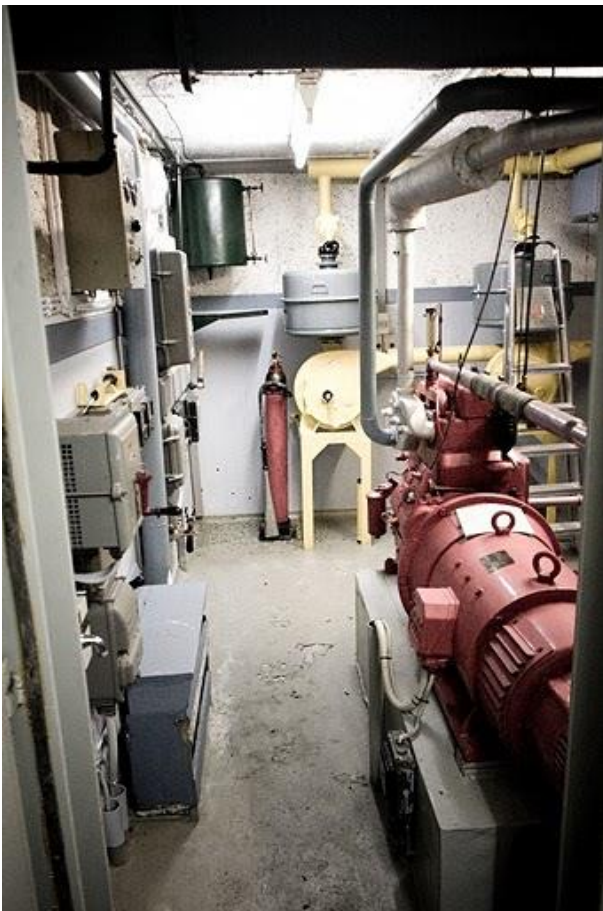
Maskinrum. Nødgenerator nederst til højre, eltavler på væggen til venstre og luftfiltre på bagvæggen. Foto: Anders Kvist 2011.
