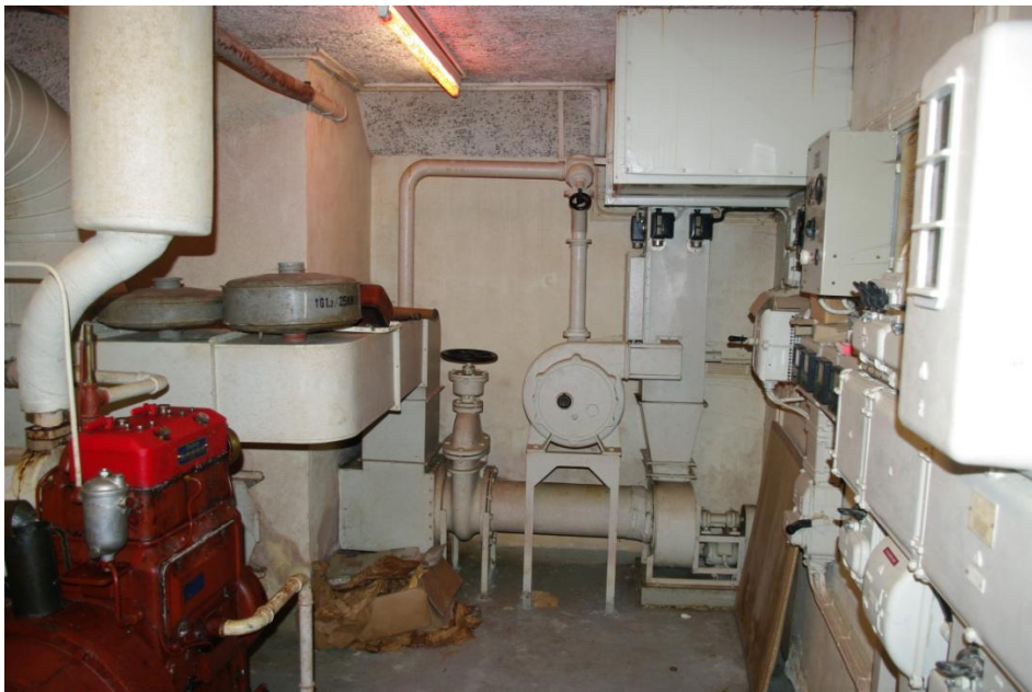
Maskinrummet. Til venstre ses nødgeneratoren, i midten ventilationsanlægget og til højre eltavlerne. Foto: Martin Pagh Jysk Koldkrigsforening 2014.
