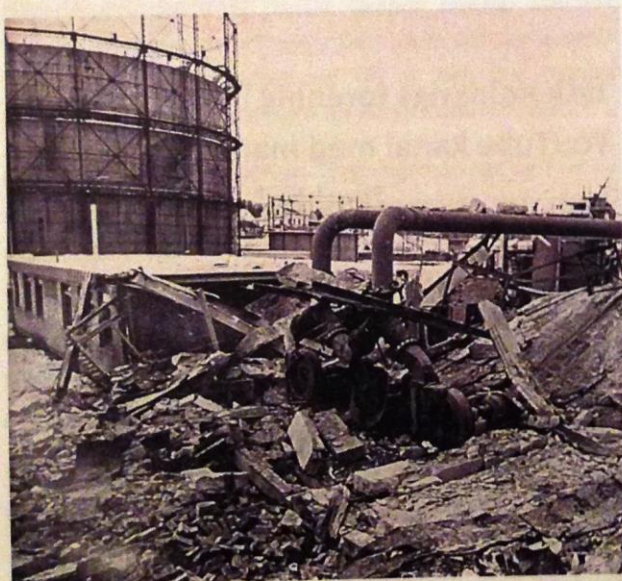
Den ødelagte tavlesal efter eksplosionen på Ålborg gasværk.
