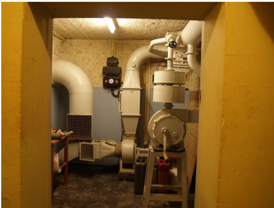
Ventilationsanlægget. De runde gasfiltre er attrapper til øvelsesbrug. Foto: Bjørn Laursen 2012.
