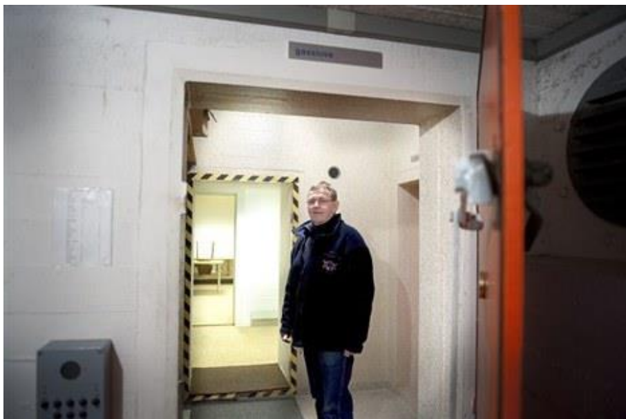
Nedgang til bunkeren sker gennem en garage. Adgangen sker gennem en gassluse, hvor der ved udgang kunne skiftes til specielle dragter og åndedrætsbeskyttelse, og hvor der ved tilbagekomst kunne ske en renselse under en bruser. På billedet er det Hjørings beredskabsinspektør Jesper Ludvigsen. Foto: Bente Poder, Nordjyske 2010.
