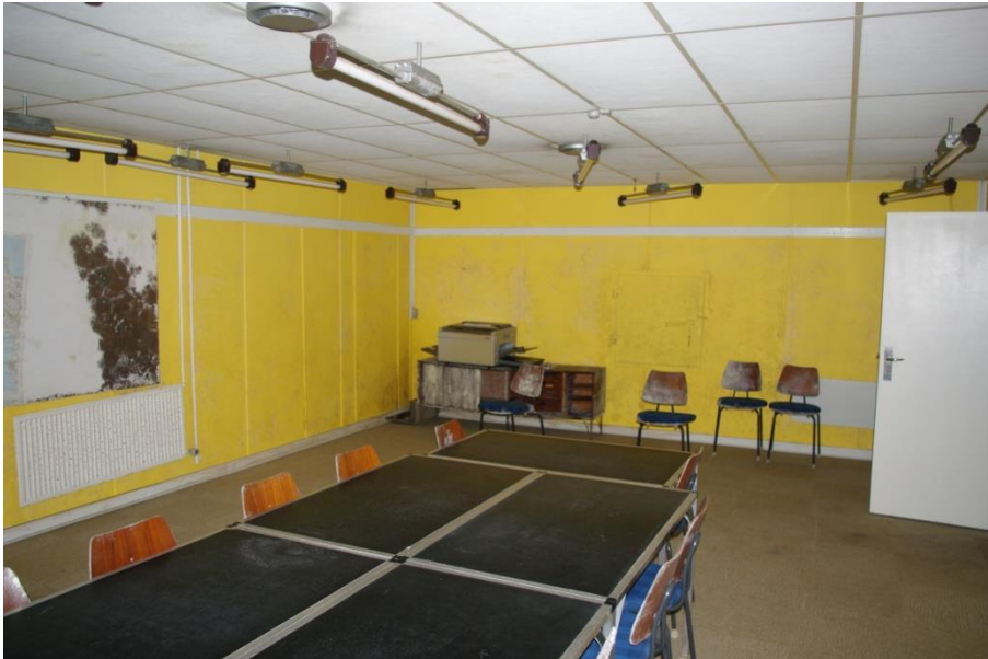
Situationsrummet. Billedet viser, at bunkeren er hårdt medtaget af fugt. Foto: Martin Pagh, Jysk Koldkrigsforening, 2014
