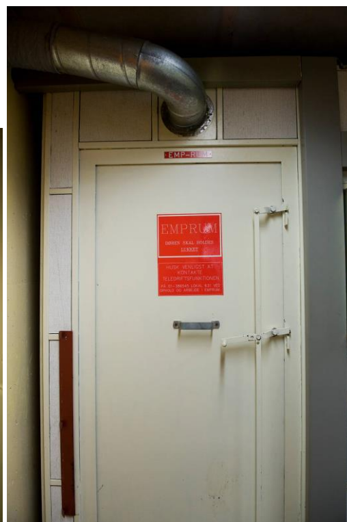
Foto til højre: Det vigtigste kommunikationsrum er installeret i et EMP rum, hvor det er beskyttet mod elektromagnetiske impulser fra en atomsprængning. EMP rum er standard i regerings- og regionsbunkerne – men er kun set i én anden kommunal KC.
