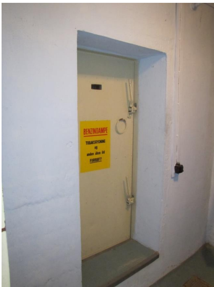
Indgang til teknikrum. Både den tunge yderdør og denne noget tyndere gassikre døre (19P7) stammer fra tyskbyggede bunkere fra besættelsen. Foto: Dennis Holzendorff Petersen 2011
