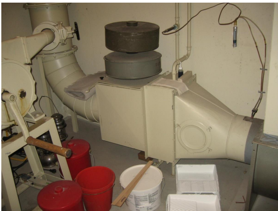
Ventilationsrum – samt håndsving hvis al strøm går. Der ligger gasfiltre klar, som kan rense luften, hvis den er forurenet af kampstoffer. Foto: Viceberedskabschef Ole Christiansen 2011.
