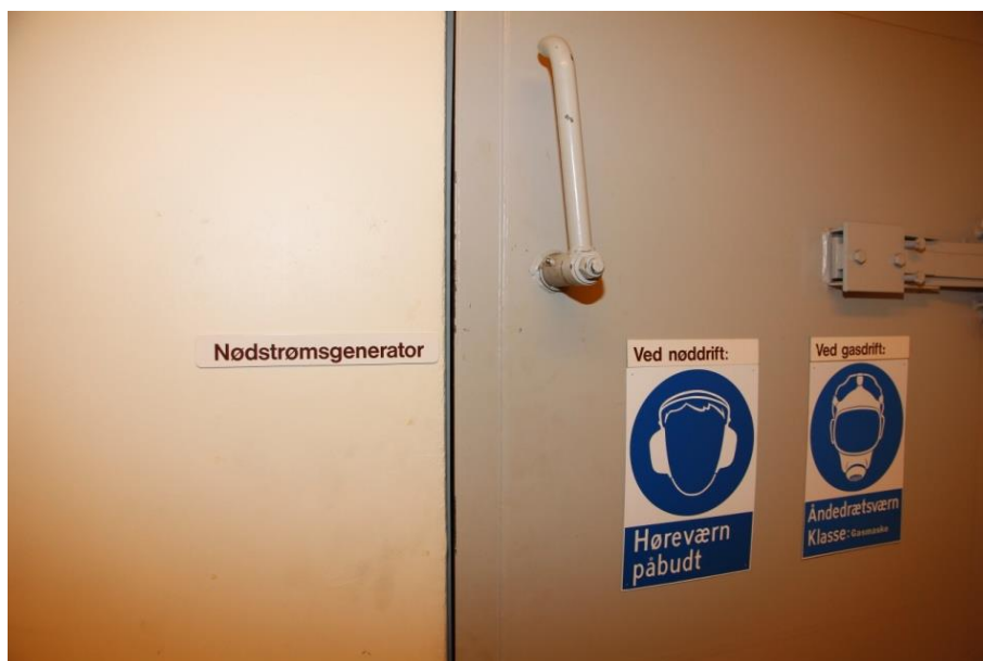
Nødstrømsanlæg ligger normalt ude for gasslusen. Det kan den sagtens, da dieselmotoren uden problemer kan bruge forurenset luft. Men skal generatoren serviceres må der så bruges gasmaske. Foto: Peter Rask 2011.
