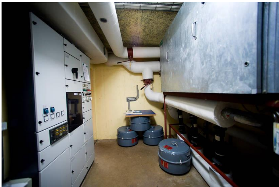
Eltavle og ventilationsanlæg. Foto: Hans Chr. Gabelgaard, Jydske vestkysten 20111018.
