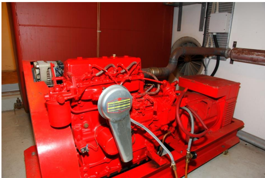
Selv om bunkeren er en af landets mest moderne er generatoren Beredskabsstyrelsen gamle standard. Det skyldes, at den model er velafprøvet og kan køre under næsten alle forhold. Foto: Peter Rask 2011.
