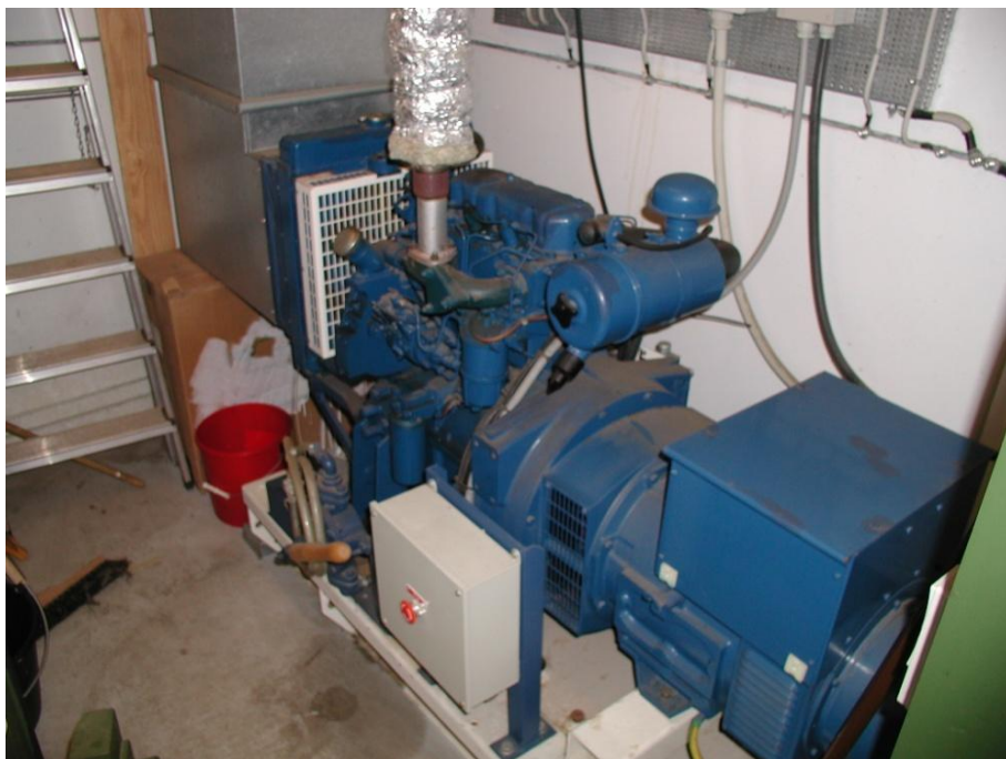
Generator. Foto: Henrik Pedersen 2011.
