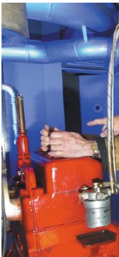
22 KVA 3 cylindret BUHK nødgenerator med 400 liter tank (nedgravet uden for bunkeren af brandhensyn) nok til 4 ugers kontinuerlig drift. Fotos: Alex Tran i Vid&Bid 2002. Bunkeren er forsynet med vand fra det offentlige ledningsnet, men har 2 reservebeholdere á 400 liter.
