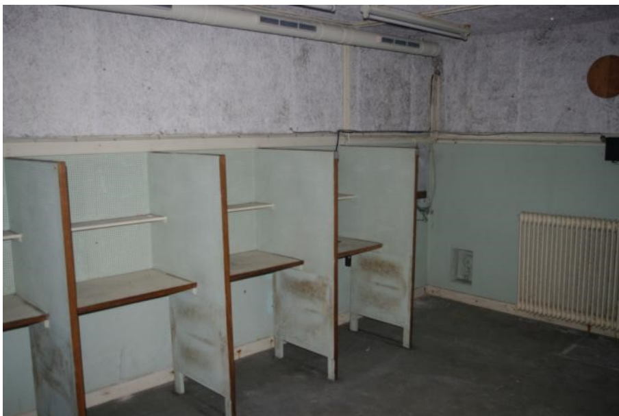
Signalrum. Det ses tydeligt, at bunkeren i dag er hårdt medtaget af fugt. Foto: Martin Pagh, Jysk Koldkrigsforening, 2014
