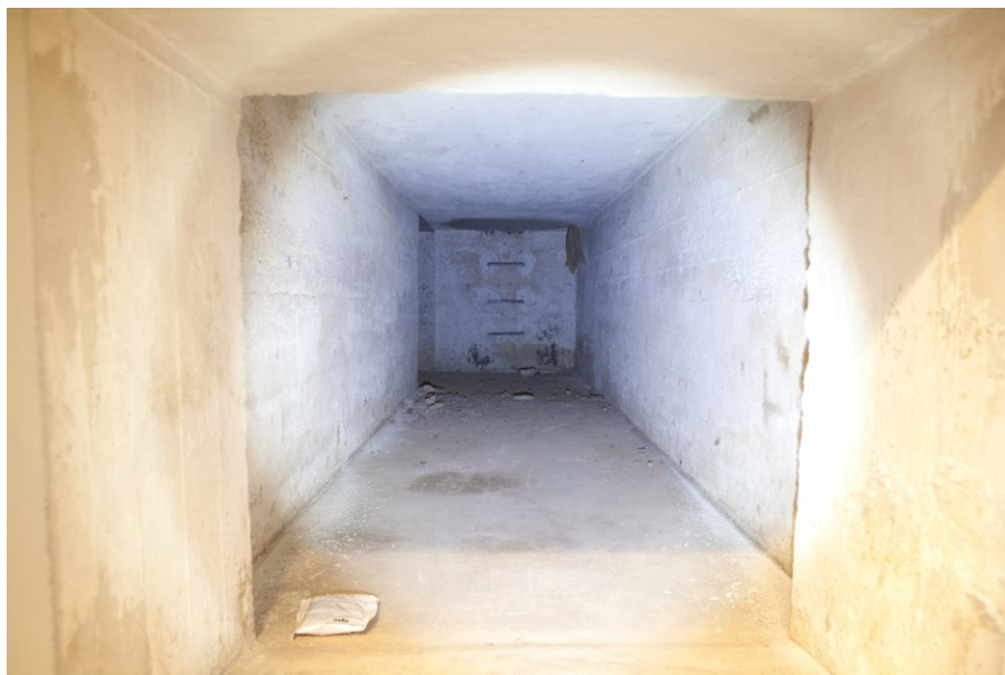
Nødudgangen fører nogle meter vandret frem før man når frem til "skorstenen", der fører op til det fri. Afstanden ud til den lodrette kanal skyldes, at den ikke må blive blokeret af murbrokker i tilfælde af, at skolebygningen over KC'en falder sammen. Foto Michael Bødstrup Hansen 2011.
