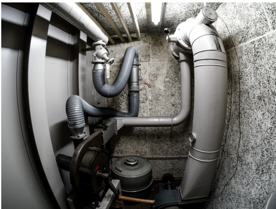
Ventilationsanlægget (vidvinkel). Foto: Jakob Færch-Jensen 2013.
