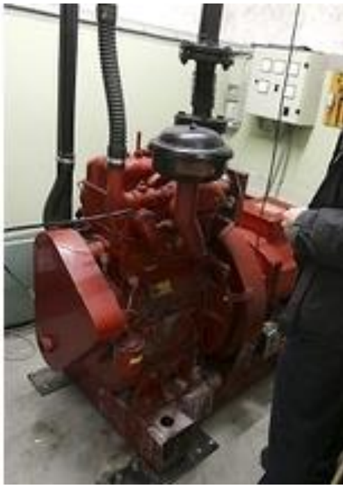
Generator. Foto: Hillerødposten 2010.
