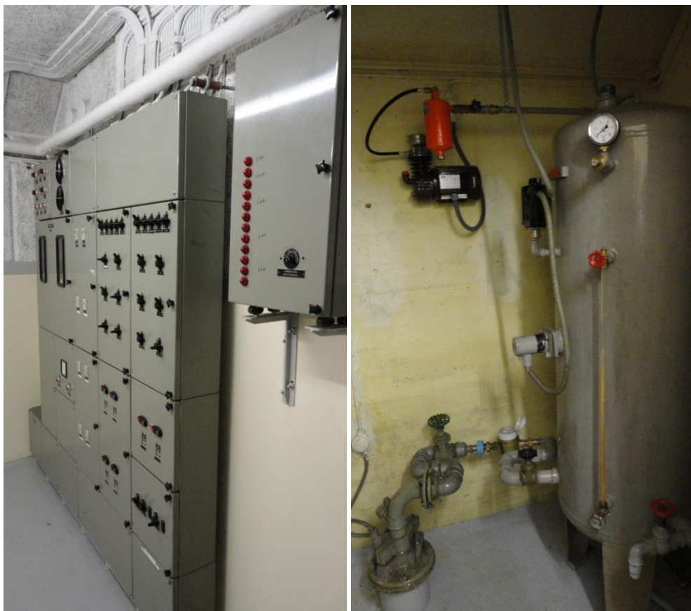
Eltavle til venstre. Brøndboring og vandtank til højre. Foto: Poul Holt Pedersen 2011.
