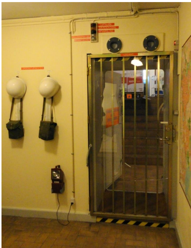
Hovedindgangen set inde fra bunkeren. Over døren ses overtryksventiler, til venstre for hjelme og gasmasker samt nødbelysning. Foto: Poul Holt Pedersen 2011.
