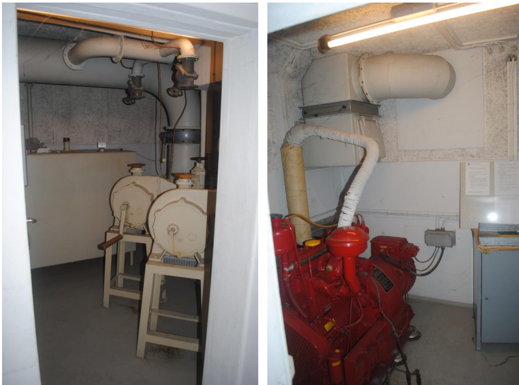
Ventilationsanlæg og nødgenerator. Foto: Tommy Cassøe 2013.
