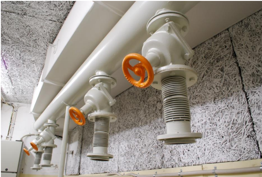
På de fire studser kan der monteres gasfilter, hvis luften er forurenet af kampstoffer. Foto: Steen Bøtke 2012.
