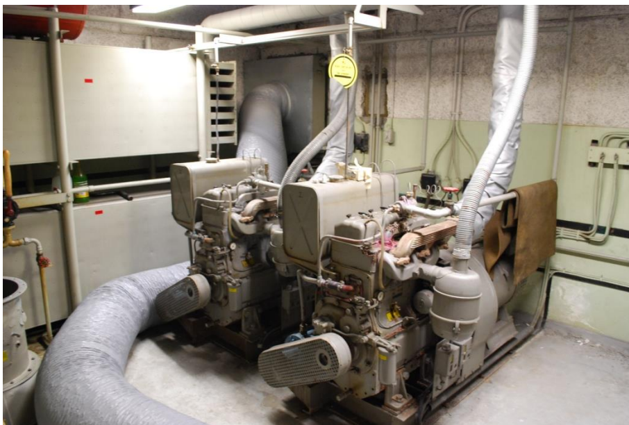
To nødgeneratorer. Foto: 'Køter'2011.
