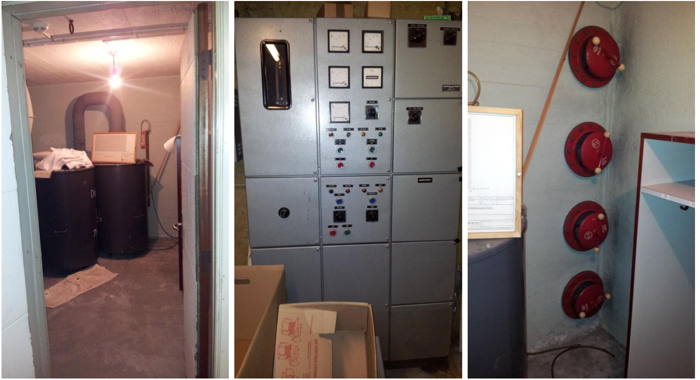
Ventilationsrum, eltavle og overtryksventiler. Foto: Jens P. Sørvin 2011.
