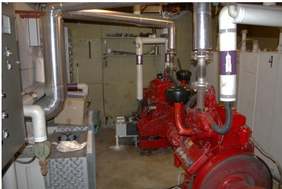
Nødgeneratorer. Foto Karsten Pedersen 2010
